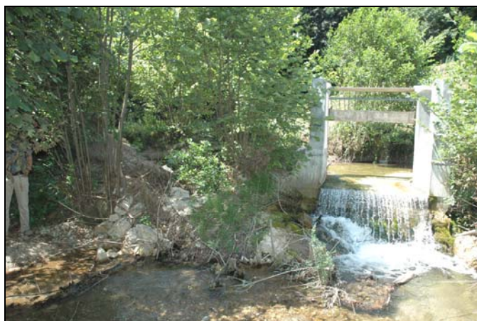
Slika 1: Poškodba stranskega jezua na mlinščici v letu 2006. Foto: D. Štepec, julij 2006. Arhiv ZVKDS – OE Novo mesto.
