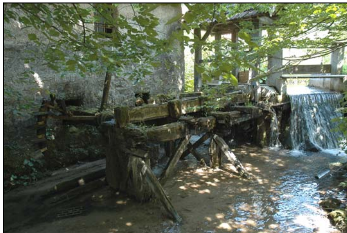
Slika 3: Uničeno pogonsko kolo ter propadajoča vodna korita. Foto: D. Štepec, junij 2013. Arhiv ZVKDS – OE Novo mesto.
